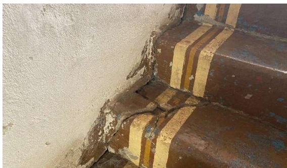
Dům vykazuje konstrukční vady
