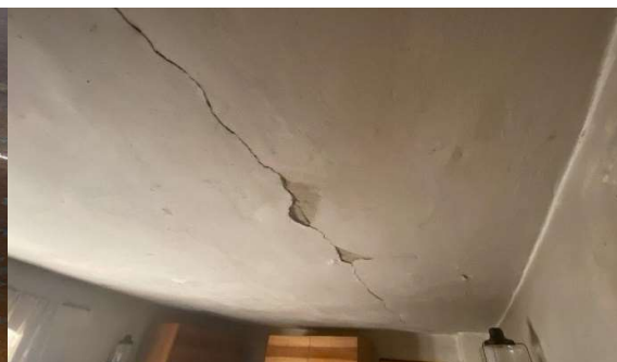
Dům vykazuje konstrukční vady
